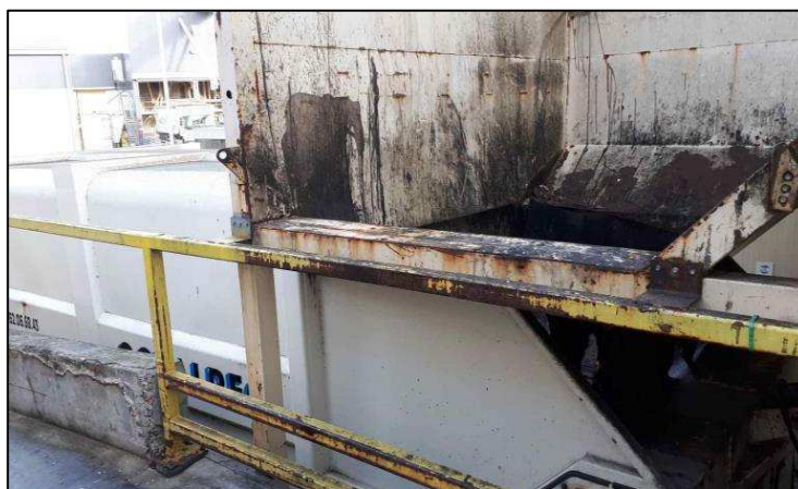
Figure 5 : Bennes de stockage des sachets non conforme
